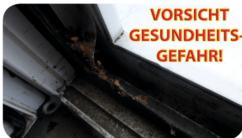
Schimmelbefall bei Kunststoff-Fenstern
